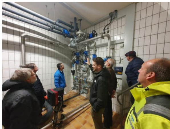
(Blick auf die neue Leitungstechnik im Hochbehälter Lautenhausen)
